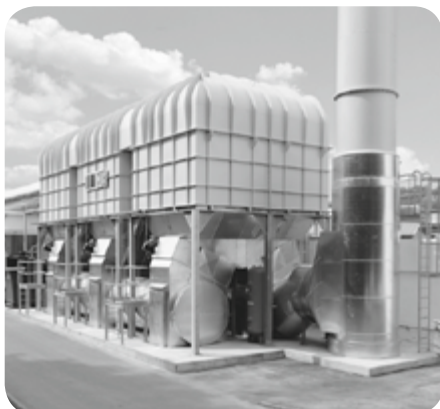
Nachverbrennungsanlage für thermisch-regenerative Abluftreinigung
