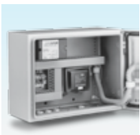
TC 4 separat von der Anlage im Schaltschrank eingebaut
